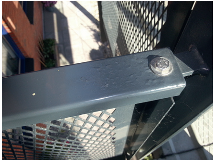
Figuur1 – corrosie door slechte voorbehandeling
